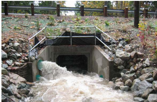
Chantrell Creek – Fish Passable Box Culvert
